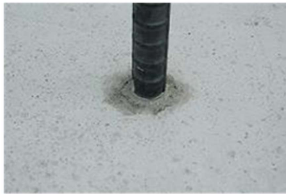
写真 4-25 セメントの濡れ色がなくなったセメフォースアンカー
